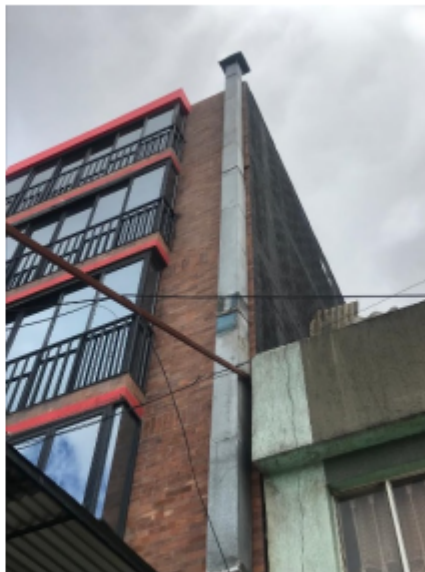
Fotografía 8. Punto de descarga del ducto de las emisiones de la estufa y el horno
